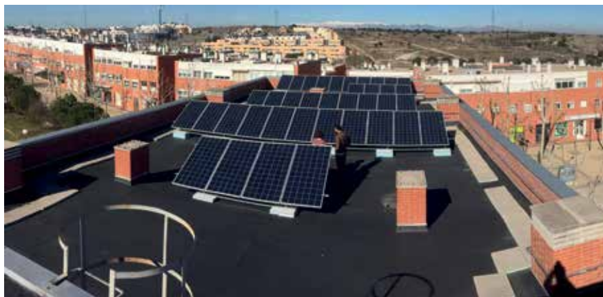
▲ Vista de los paneles instalados en la sede de la entidad.
