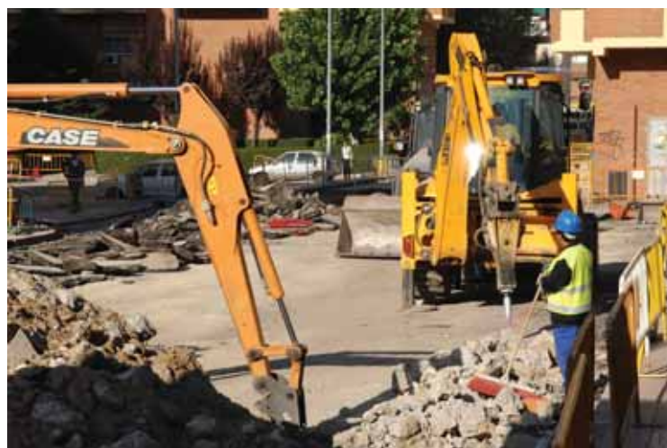
Los operarios trabajan con plena actividad para acondicionar el que será uno de Centros Comerciales Abiertos de referencia en Sanse.
