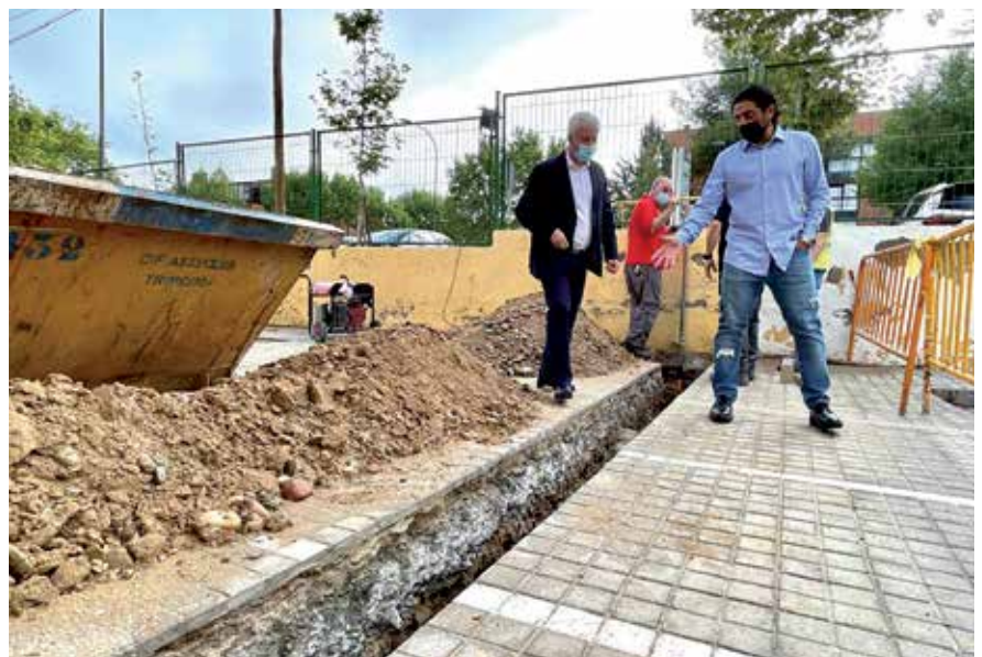
▲ El alcalde, Narciso Romero, y el vicealcalde delegado de Obras y Servicios, en una visita a las obras de un colegio de nuestra ciudad.
